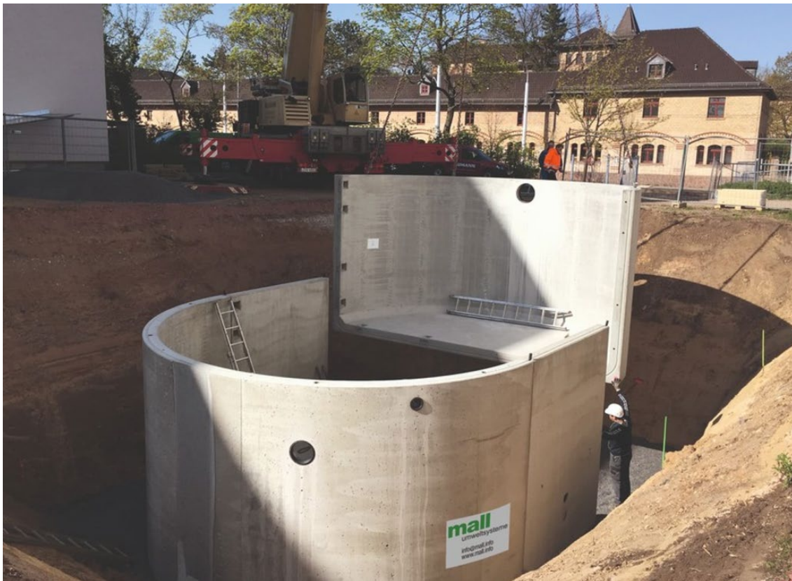
Abbildung 25: Beispielfoto unterirdisches Rückhaltebecken aus Beton [Quelle: Mall GmbH]
