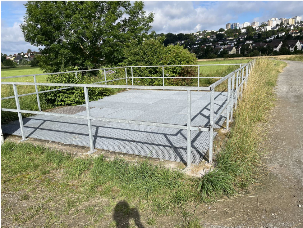
Abbildung 10: Foto Bauwerk „BEI SKO Eisweiher“ des Abwasserverbandes Fulda
