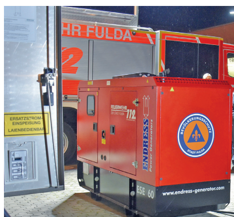
Die an verschiedenen Feuerwehrhäusern im Stadtgebiet stationierten Notstromerzeuger sind einfach zu bedienen.
