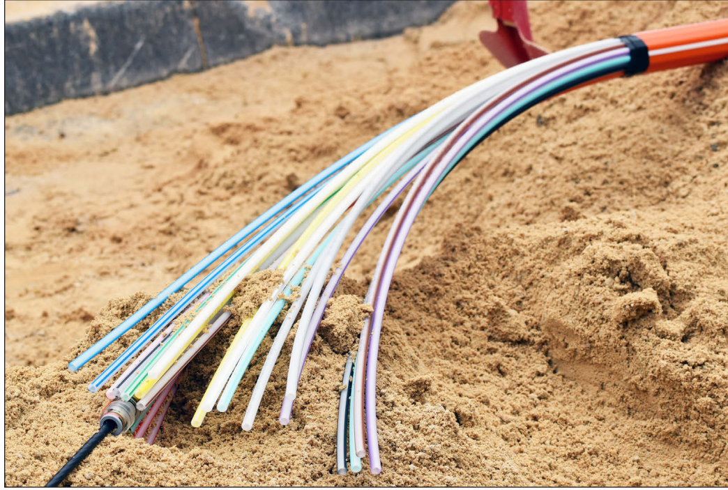
Tausende Kilometer Glasfaserleitungen werden in den nächsten Jahren im Landkreis Fulda im Rahmen eines Förderprojekts verlegt – den Anfang machen die Fuldaer Stadtteile. Fotos: fd
