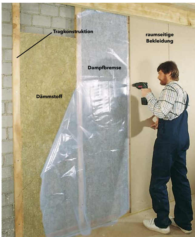
Schichtaufbau einer Innendämmung - eine Dampfbremse als separates Bauteil ist nicht bei allen Systemen erforderlich.
