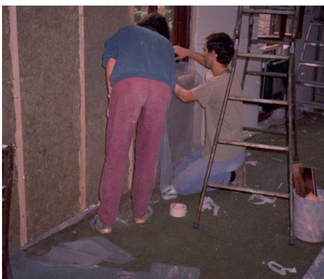
Innendämmung aus Mineralfaserplatten mit Dampfbremse; hier die Herstellung des Anschlusses am Fensterrahmen
