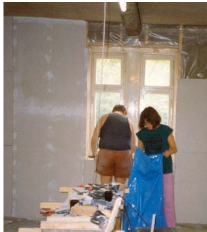
Montage einer Innendämmung in einem kleinen Bauernhaus Baujahr 1913 mit Mineralfaserdämmung, Dampfbremse und Gipskartonplatten.
