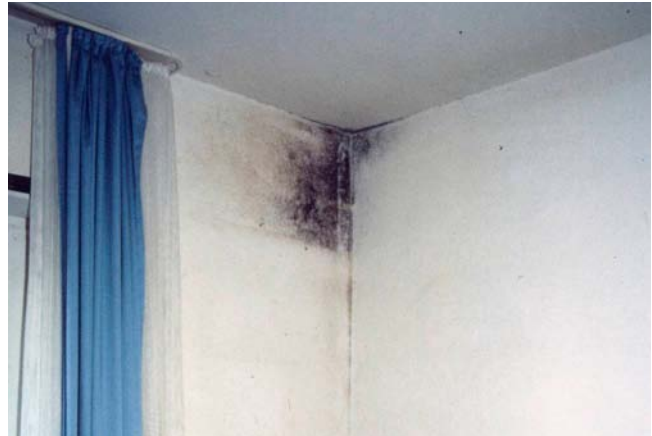
An einer durch Wärmebrückenwirkung eines Betonsturzes ausgekühlten Wandfläche schlägt sich Feuchtigkeit nieder. Der Schimmelpilz hat ideale Bedingungen für sein Wachstum.
