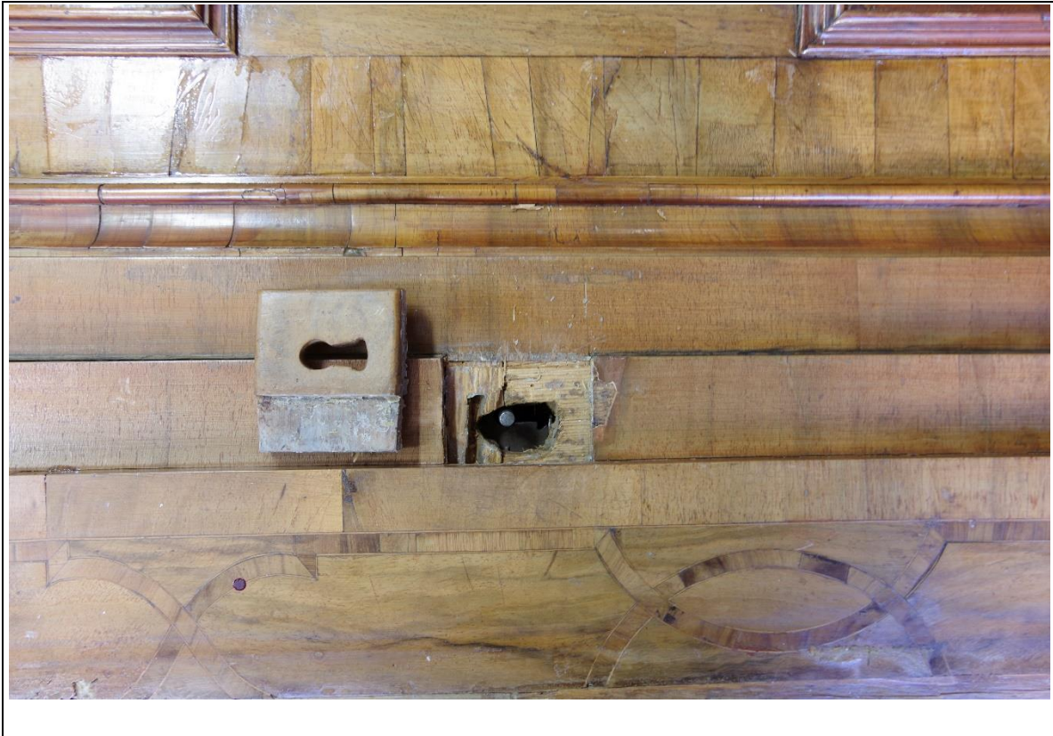
Abbildung 9: Detail ausgebaute unpassende Schlüssellochabdeckung
