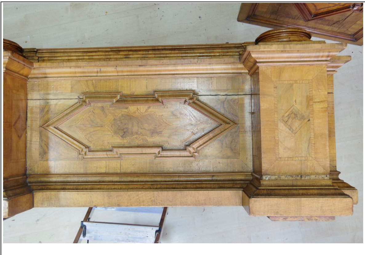
Abbildung 12 Sockel mit fehlenden Profilen und Rissen
