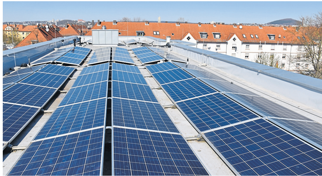
Photovoltaikanlagen (wie hier auf dem Dach der Sturmusschule im Fuldaer Süden) sind ein Beitrag zur Senkung der Treibhausgasemissionen in der Stadt. Im Klimaschutzkonzept sollen viele weitere Optionen ausgelotet werden. Foto: Stadt Fulda
